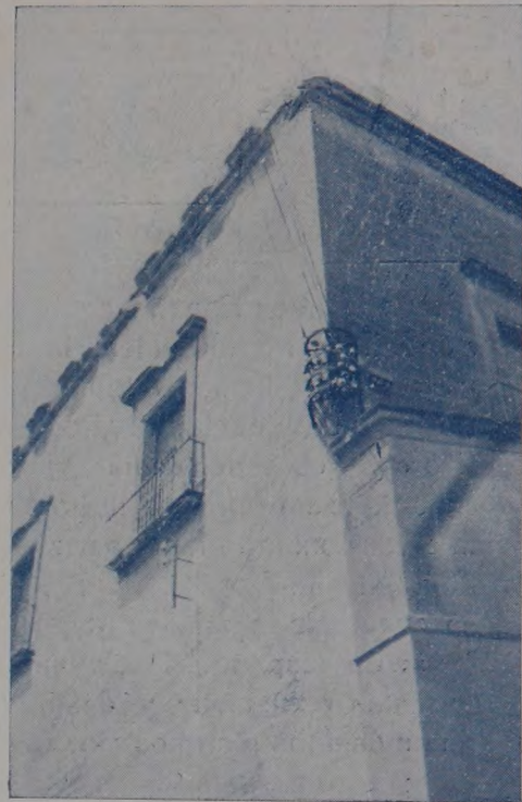
...El lamentable estado en que se encuentran todas las cornisas...
